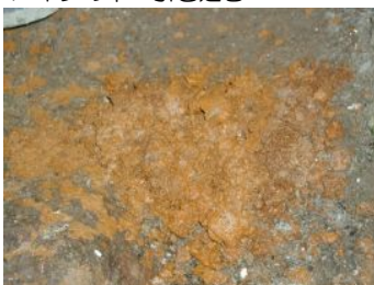
管内より排出されたスケールの一部
